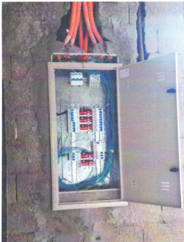
Foto 8: Instalação de quadro e disjuntores.
